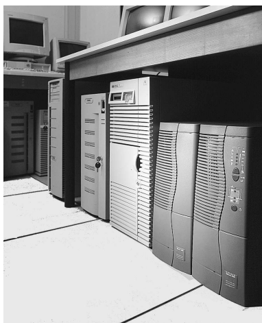
Fig. N30b : Onduleur réalisant la disponibilité et la qualité de l'énergie qui alimente des ordinateurs
